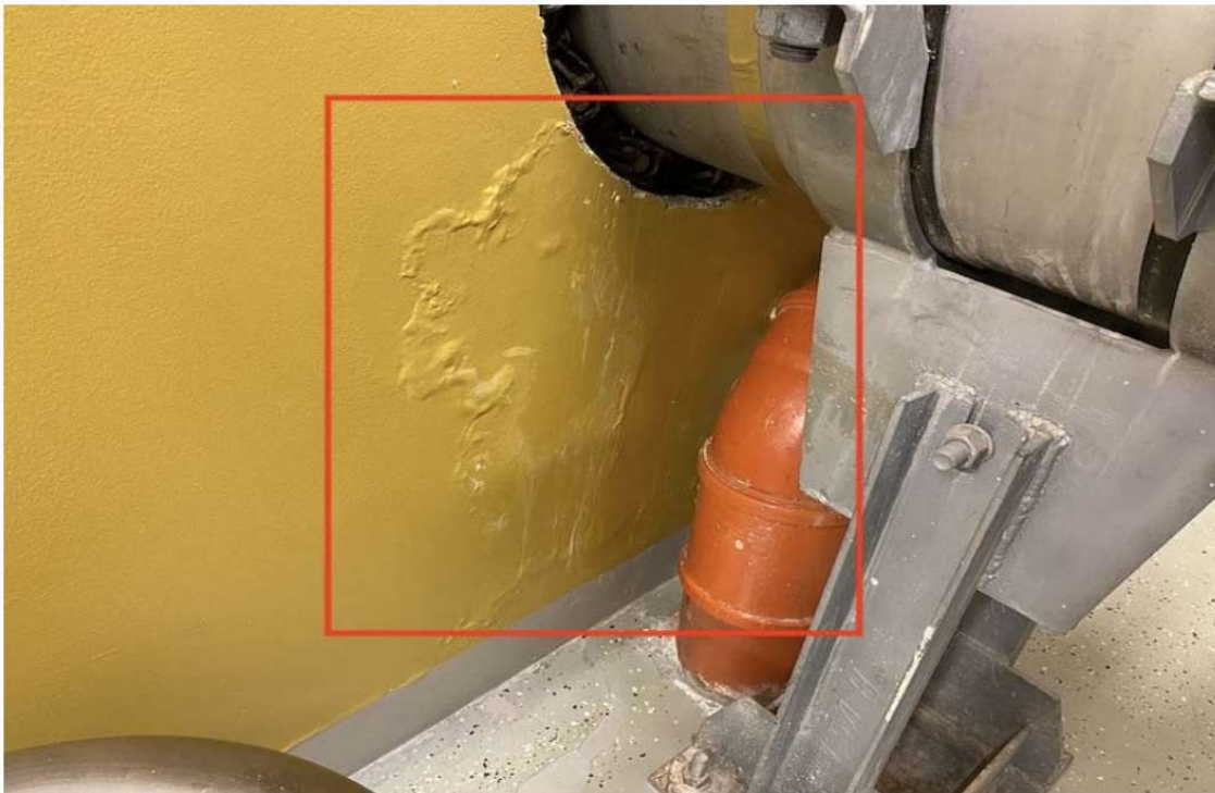
Fotod 15-16. Osoneerimismahuti välispindadel on näha niiskuskahjustuste poolt tekitatud värvi kibrutamisi, soolade karboniseerumist ja isegi kuivanud, kui ka värseid veeniresid.
