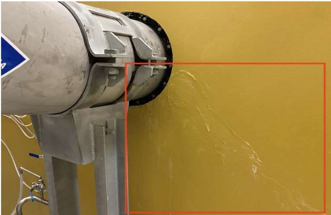
Fotod 5-6. Osoneerimismahuti välispindadel on näha niiskuskahjustuste poolt tekitatud värvi kobrutamisi, soolade karboniseerumist ja isegi kuivanud, kui ka värsked veeniresid.
