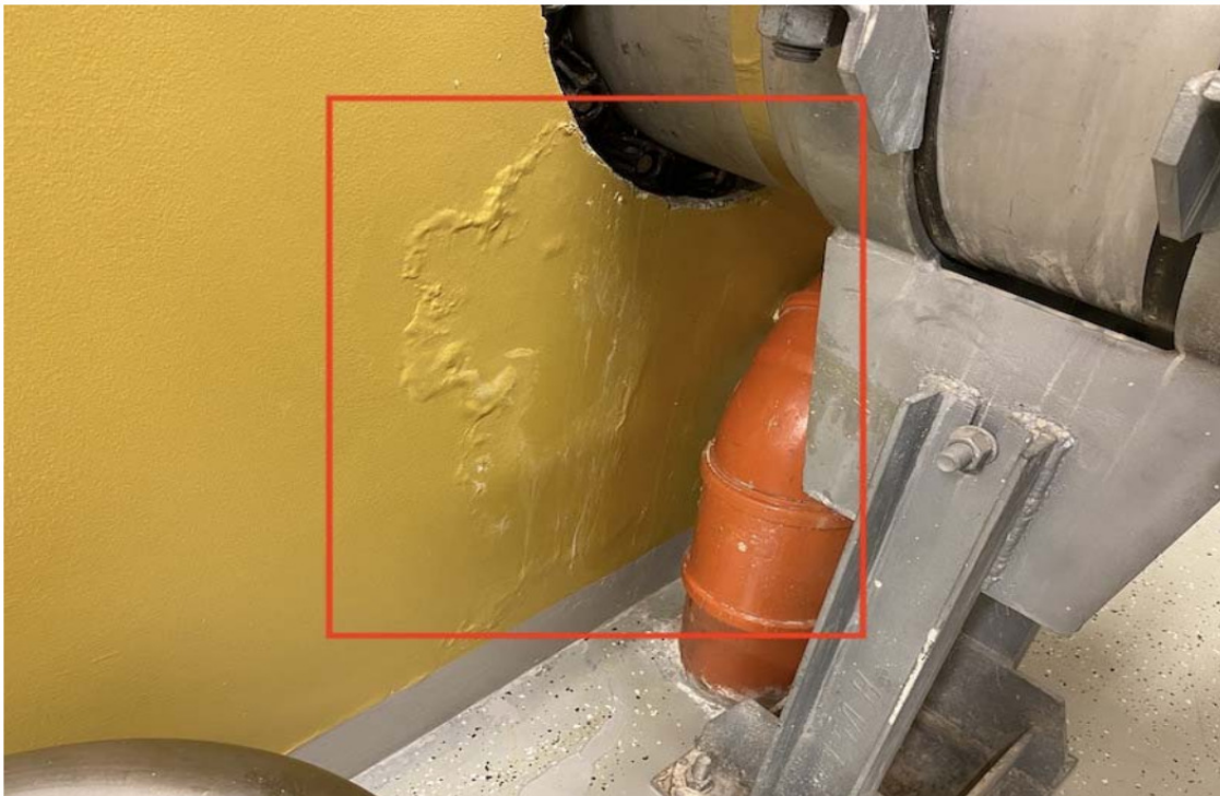
Fotod 15-16. Osoneerimismahuti välispindadel on näha niiskuskahjustuste poolt tekitatud värvi kobrutamisi, soolade karboniseerumist ja isegi kuivanud, kui ka värseid veeniresid.
