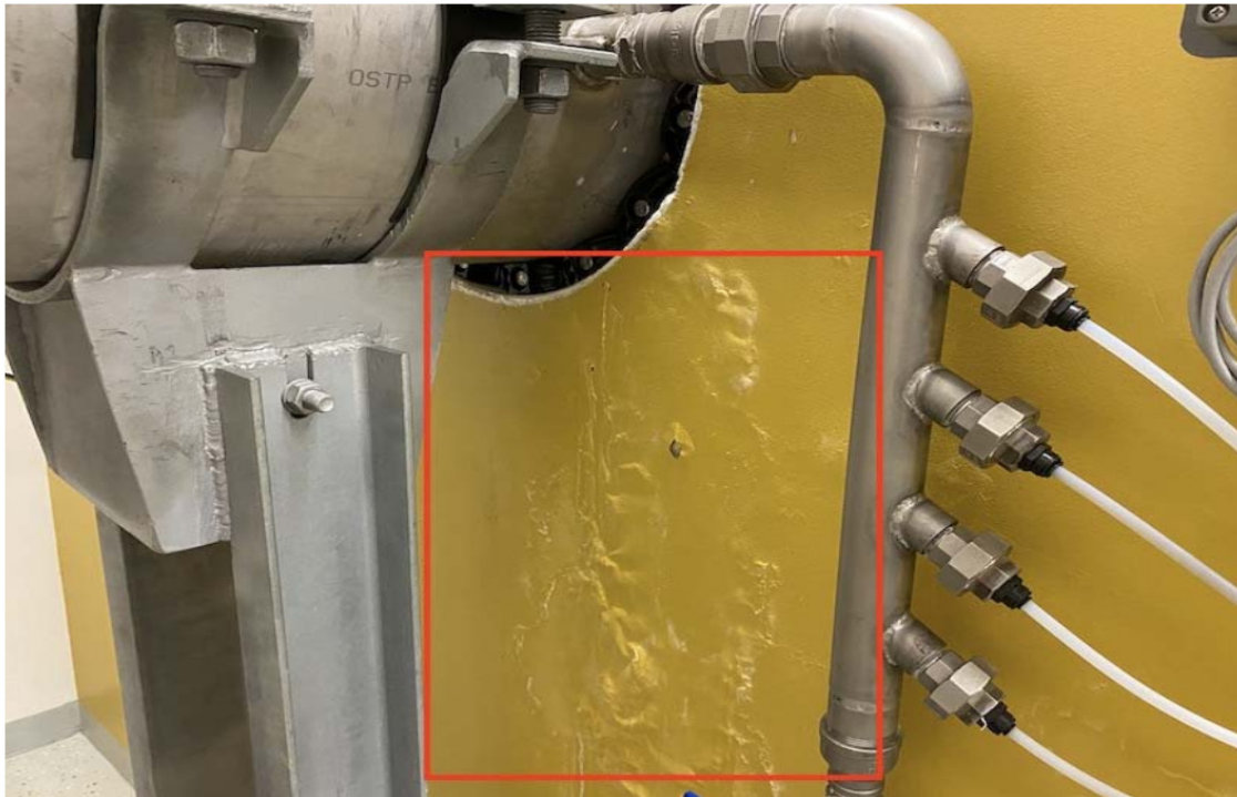
Fotod 7-8. Osoneerimismahuti välispindadel on näha niiskuskahjustuste poolt tekitatud värvi kobrutamisi, soolade karboniseerumist ja isegi kuivanud, kui ka värseid veeniresid.
