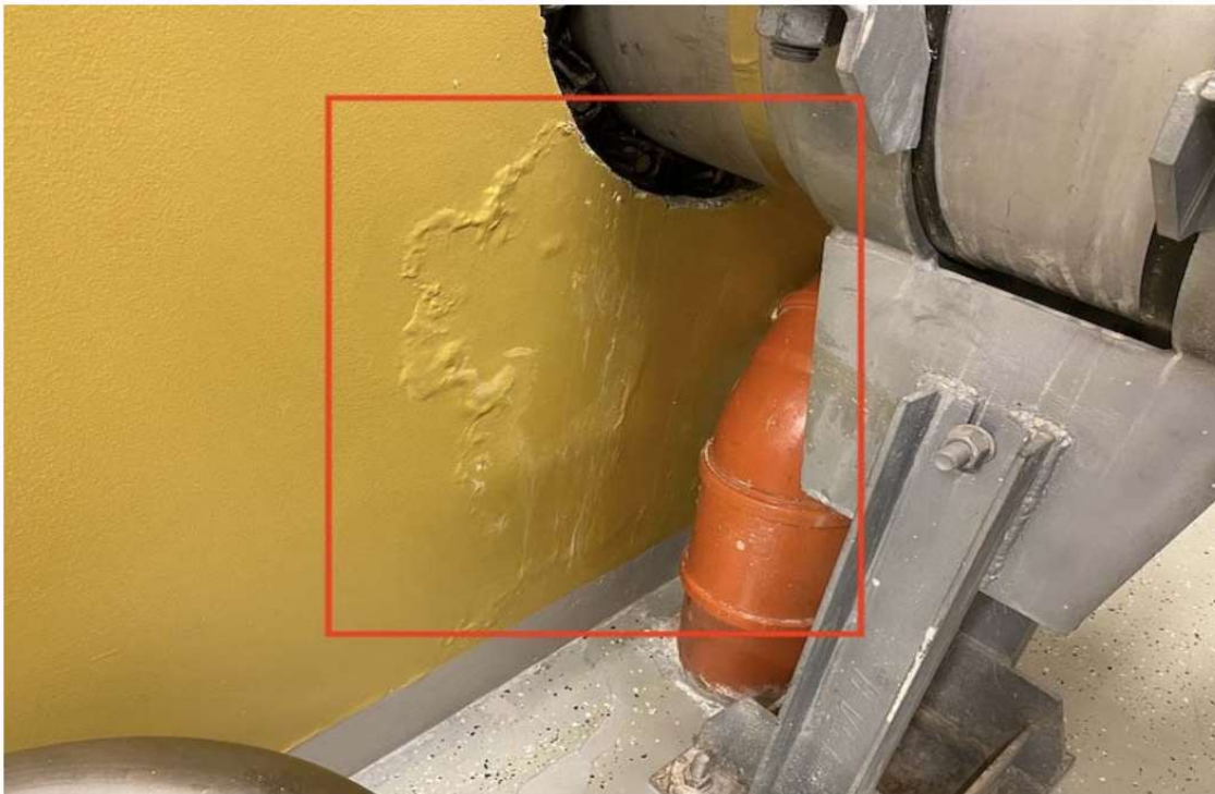
Fotod 15-16. Osoneerimismahuti välispindadel on näha niiskuskahjustuste poolt tekitatud värvi kibrutamisi, soolade karboniseerumist ja isegi kuivanud, kui ka värseid veeniresid.
