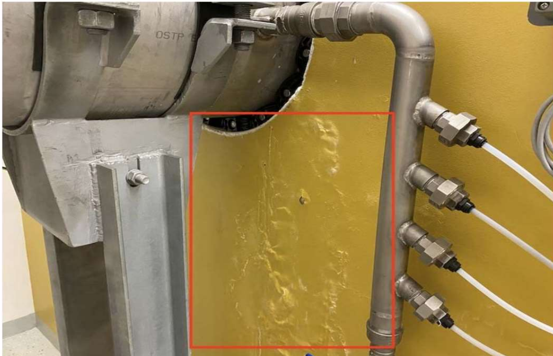
Fotod 7-8. Osoneerimismahuti välispindadel on näha niiskuskahjustuste poolt tekitatud värvi kibrutamisi, soolade karboniseerumist ja isegi kuivanud, kui ka värseid veeniresid.
