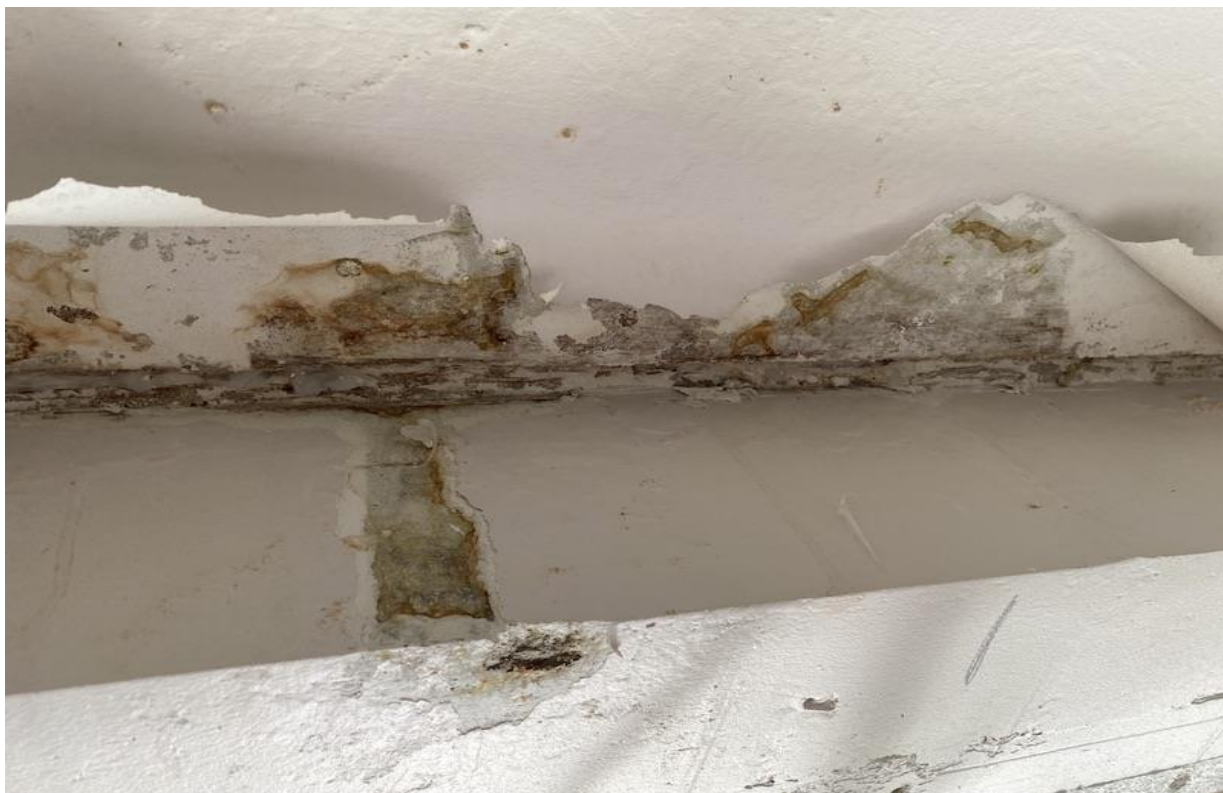
Fotod 5-6. Koridori lakke tekkinud niiskuskahjustused asuvad trepikojast katusele pääsu ukse all vahelae konstruktsioonil.
