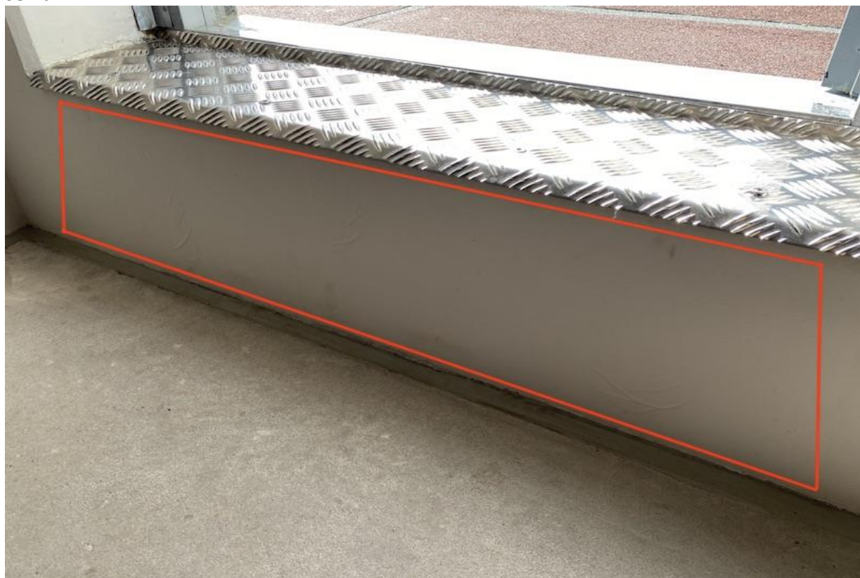
Foto 21. Katuselepääsu uke all trepikoja poolsel seinal on niiskuskahjustus.
