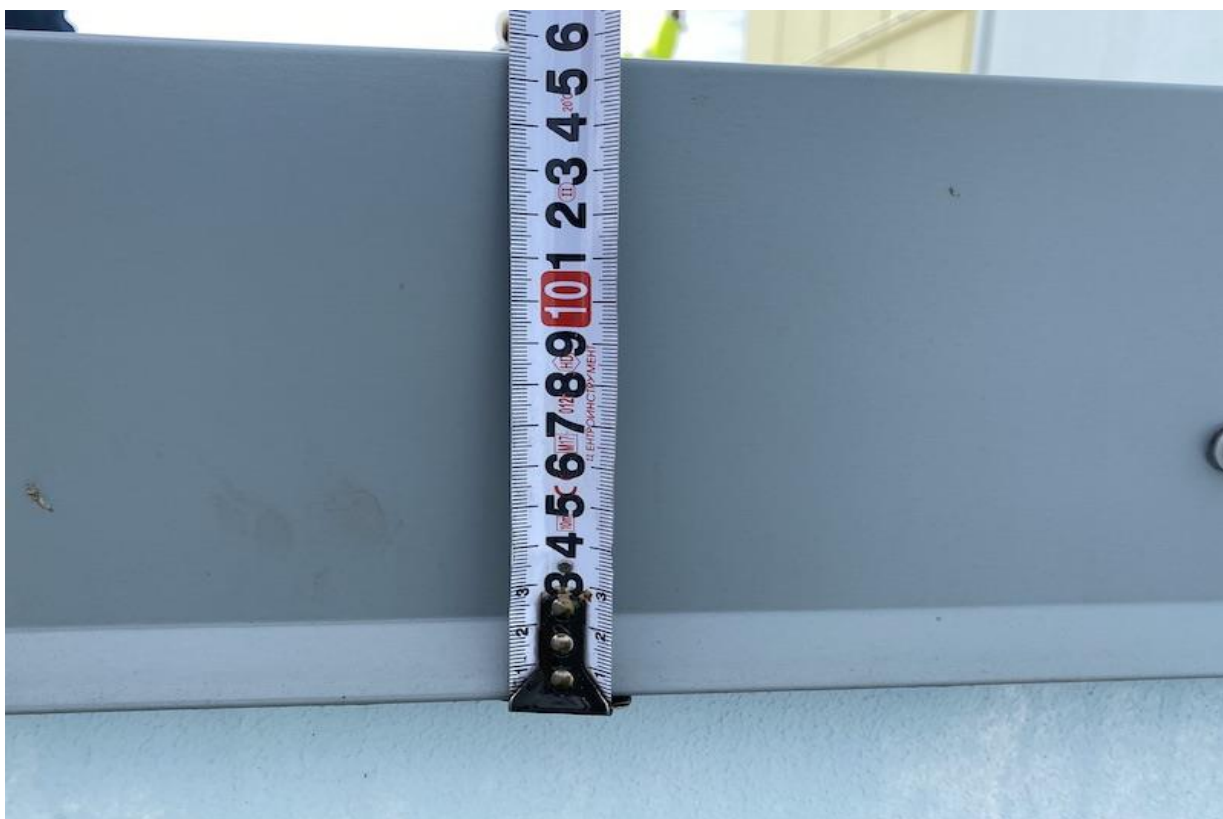
Fotod 39-40. Parapeti kõrgus on ca 440mm, kattepleki allapööre katuse küljes on 60mm ja fassaadi pool ca 160mm.
