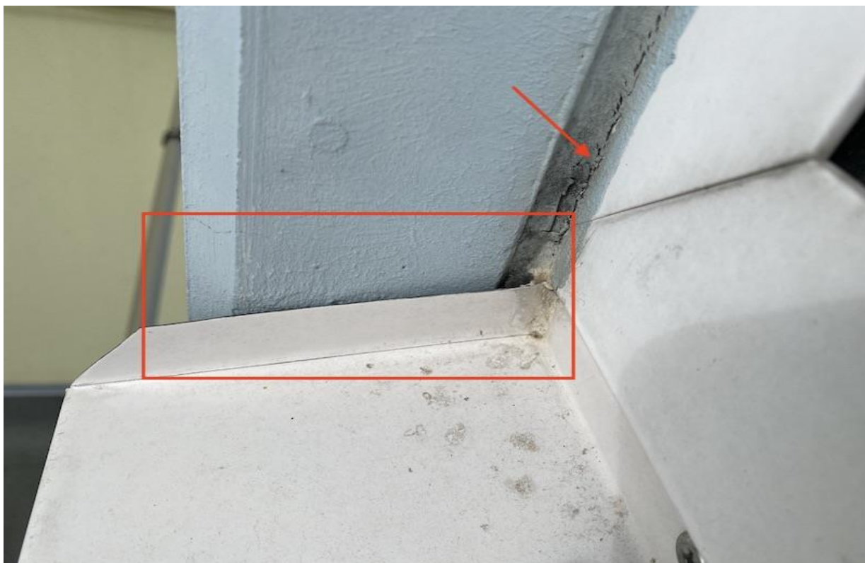
Foto 49. Trepikoja aknaplekkide servad ei ole veetihedad.
