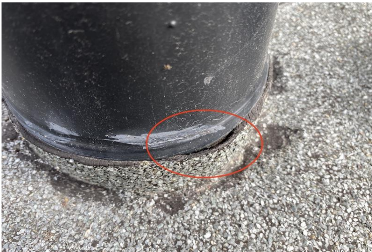
Foto 45. Katuse tuulutuskorstende ümber on mõnel juhul katusekate lahti.
