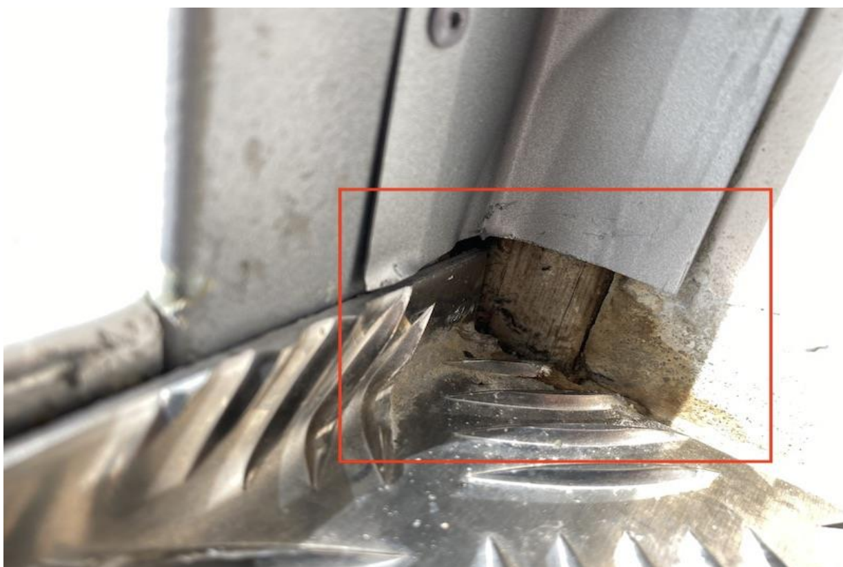
Fotod 22-23. Katuselepääsu ukse all katuse pool küljes on astmeplekk veekindlalt uksepakuga liitmata. Nurkasid on parandatud bituumenmastiksiga.
