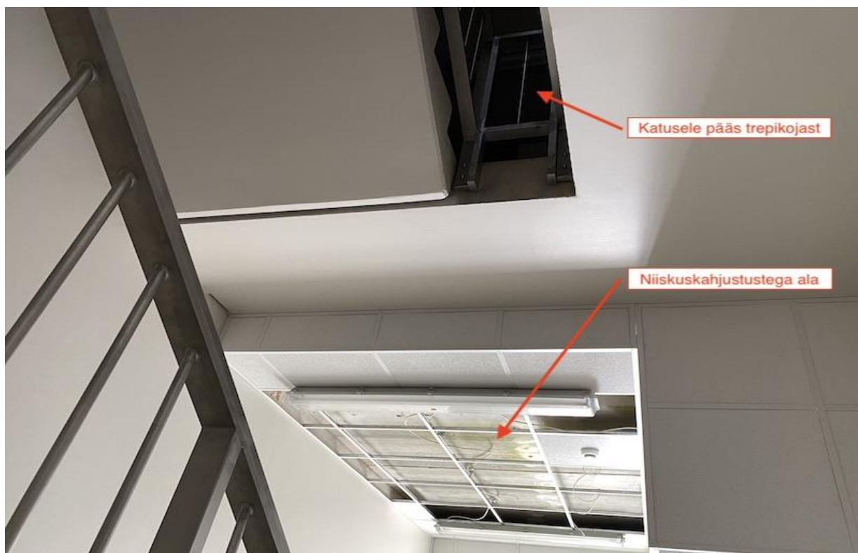
Foto 4. Koridori lakke tekkinud niiskuskahjustused asuvad trepikojast katusele pääsu ukse all vahelae konstruktsioonil.
