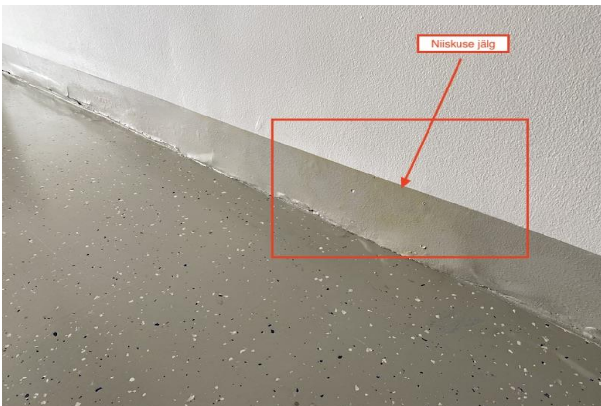
Fotod 16-17. Trepikoja perimeetri seina allservas põranda kohal on krohv lahti, esineb krohvipragusid, kobrutamist ja ka niiskuskahjustusi.
