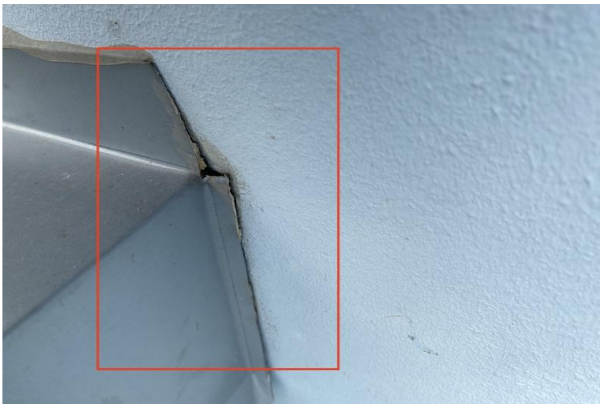
Foto 43. Parapetipleki trepikoja seinaliide ei ole veetihe.
