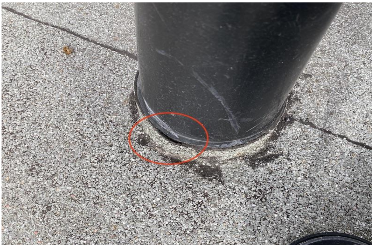
Foto 44. Katuse tuulutuskorstende ümber on mõnel juhul katusekate lahti.
