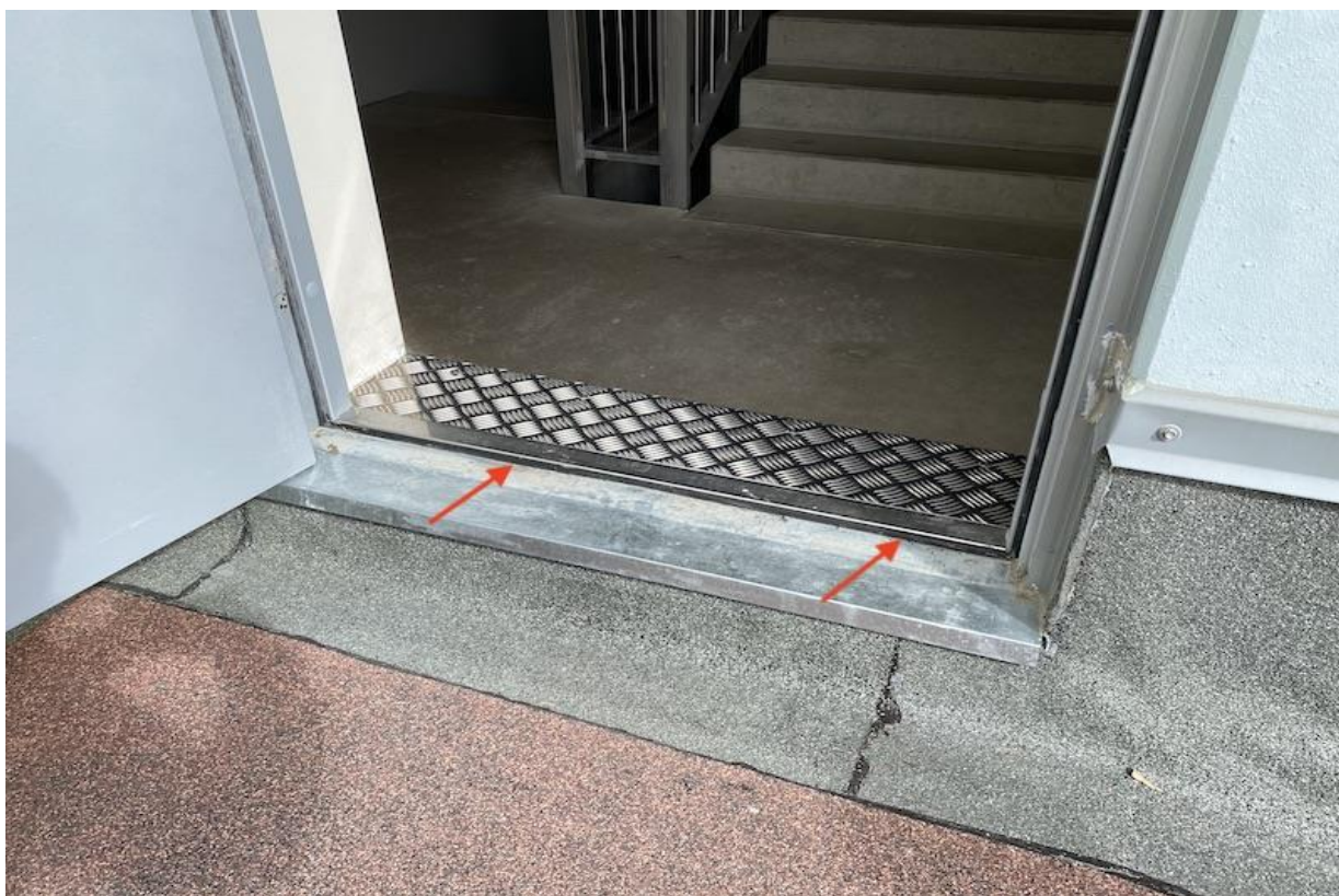
Fotod 24-25. Katusele pääsu ukse all katuse pool küljes on astmeplekk veekindlalt uksepakuga liitmata.
