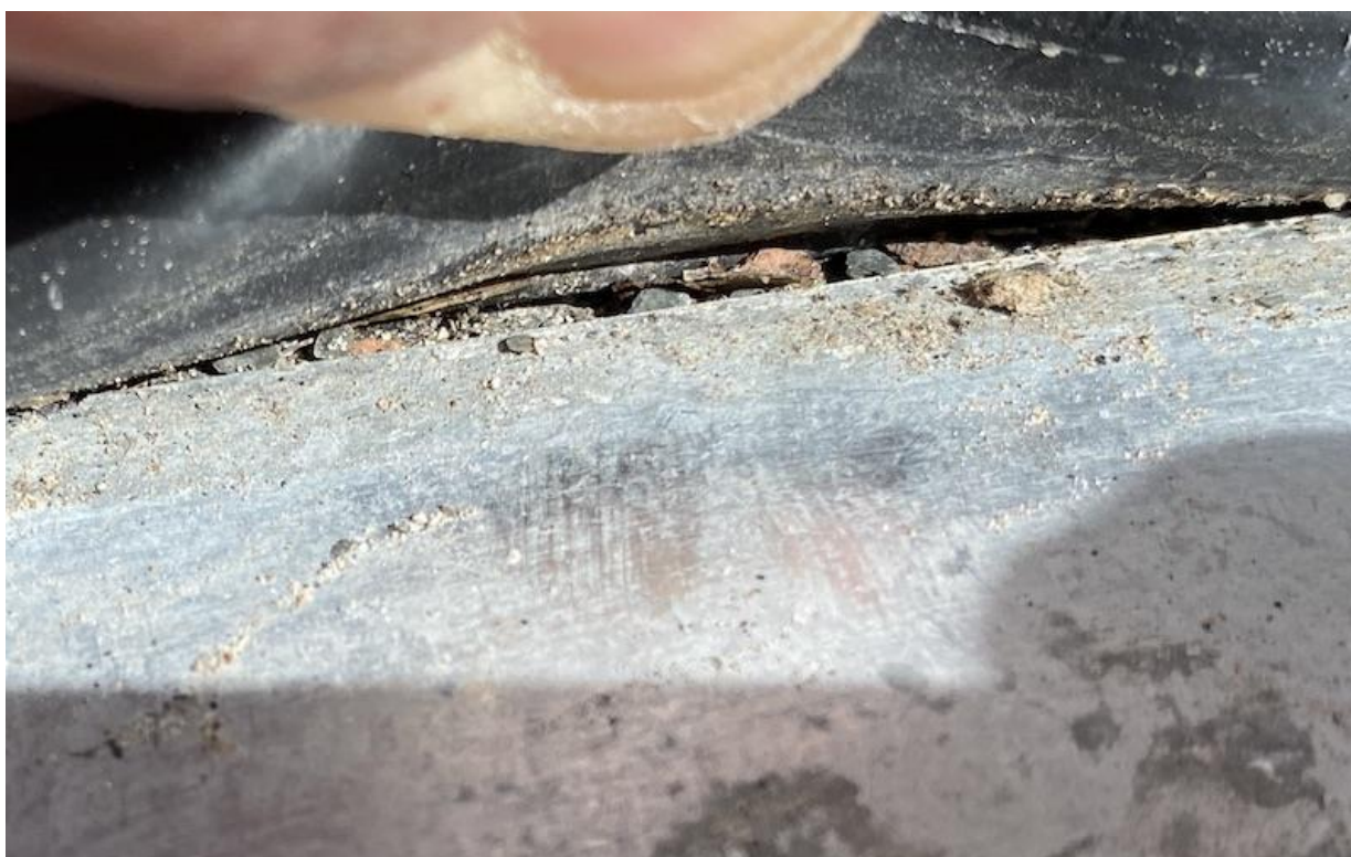
Foto 26. Katusele pääsu ukse all katuse pool küljes on astmeplekk veekindlalt uksepakuga liitmata.
