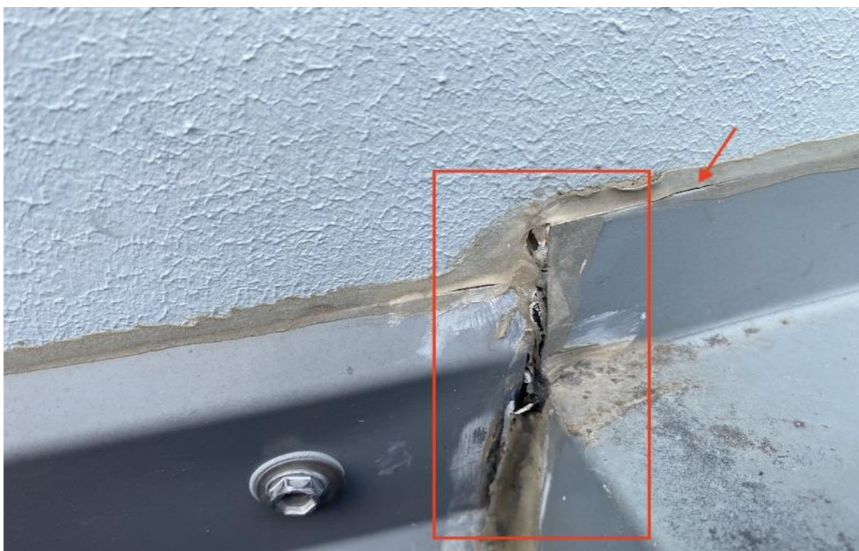
Foto 42. Parapetipleki ja katusekatte ülespöörde lõpetuspleki trepikoja poolne ühendus ei ole veetihe.
