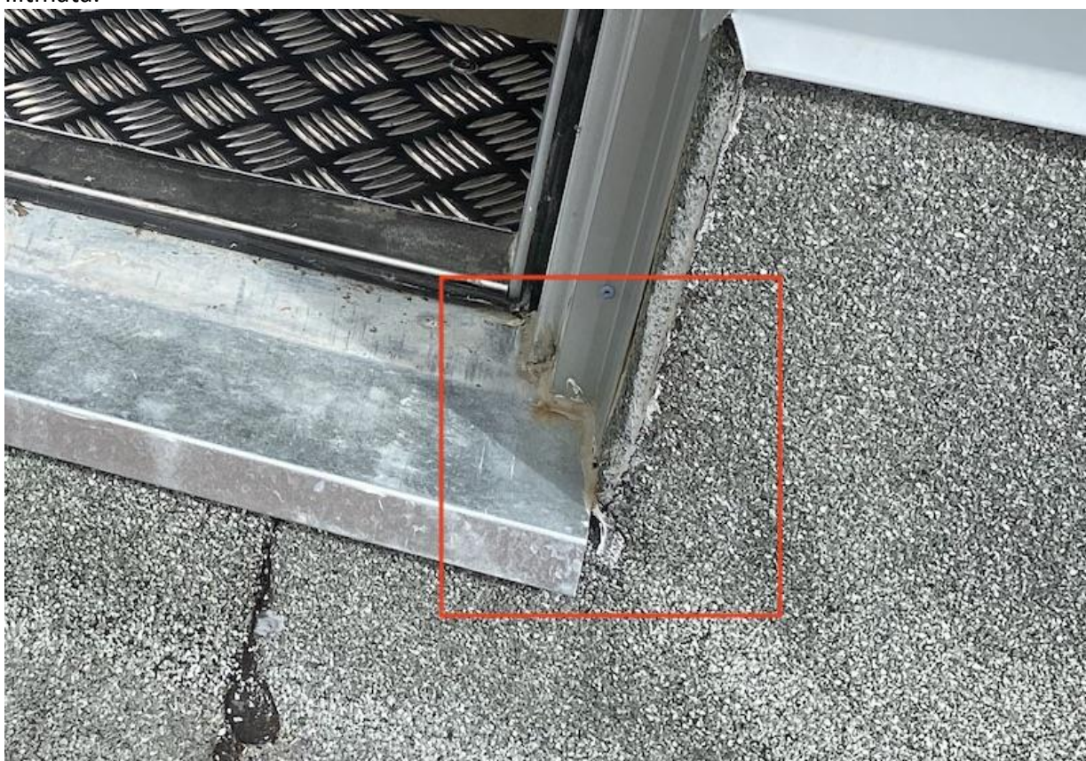
Foto 27. Ukse astmeplekil puuduvad külgmised ülespöörded.
