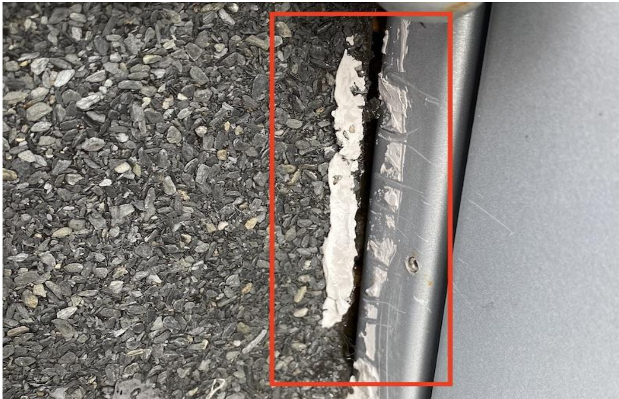
Foto 50. Trepikoja viimase korruse katusele pääsu ukse juures on katusekatte ja ukseraami vahel tühimik.
