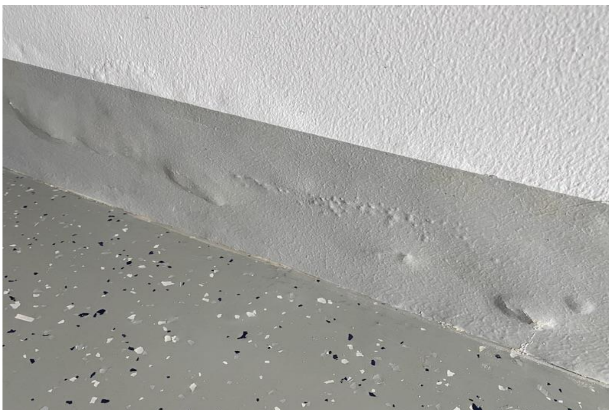
Fotod 18-19. Trepikoja perimeetri seina allservas põranda kohal on krohv lahti, esineb krohvipragusid, kobrutamist ja ka niiskuskahjustusi.
