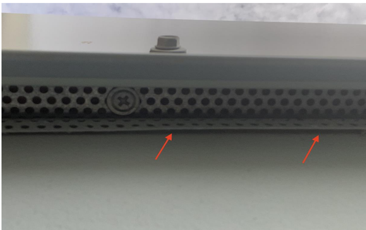
Foto 41. Fassaadi pool küljes on parapeti alla paigaldatud perforeeritud vastuplekk, mis kohati jääb seinast eemale.
