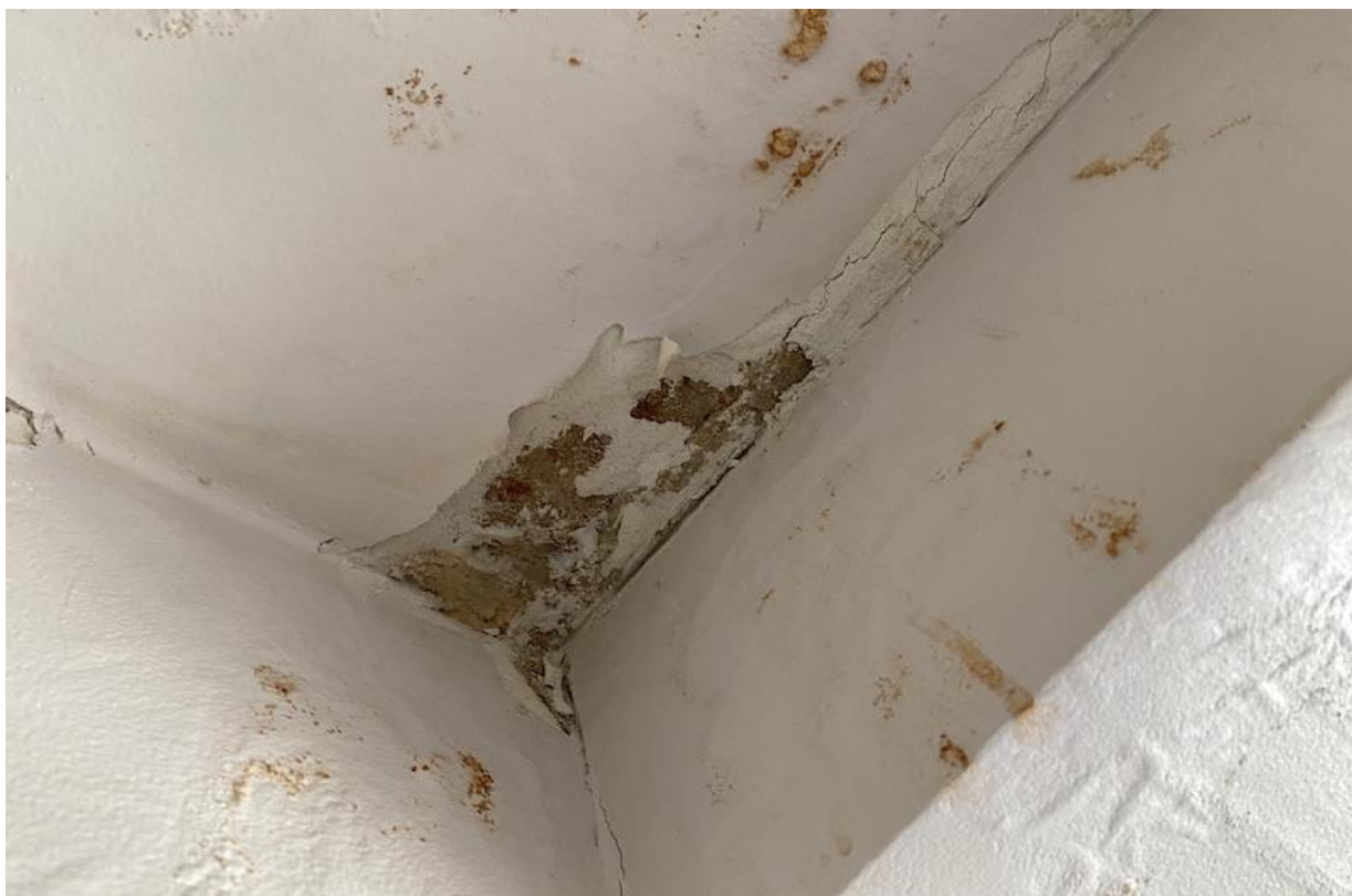
Fotod 9-10. Koridori lakke tekkinud niiskuskahjustused asuvad trepikojast katusele pääsu ukse all vahelae konstruktsioonil.
