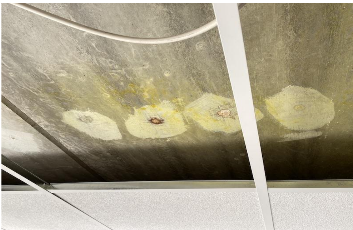
Fotod 7-8. Koridori lakke tekkinud niiskuskahjustused asuvad trepikojast katusele pääsu ukse all vahelae konstruktsioonil.
