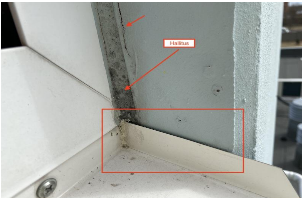
Foto 48. Trepikoja aknaplekkide servad ei ole veetihedad.
