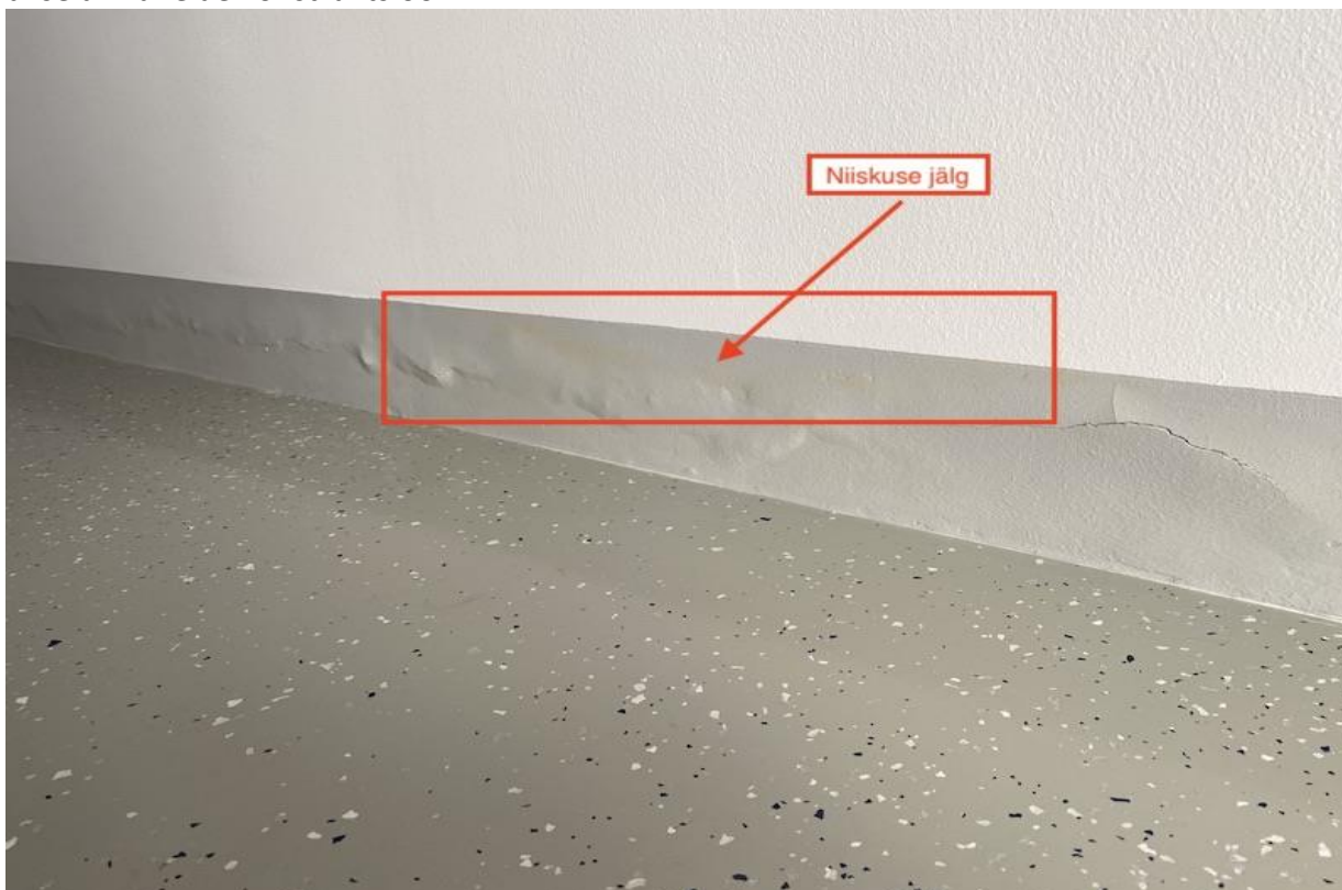
Foto 15. Trepikoja perimeetri seina allservas põranda kohal on krohv lahti, esineb krohvipragusid, kobrutamist ja ka niiskuskahjustusi.
